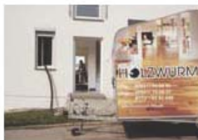
Die Absauganlage befindet sich auf einem Anhänger vor dem jeweiligen Gebäude
